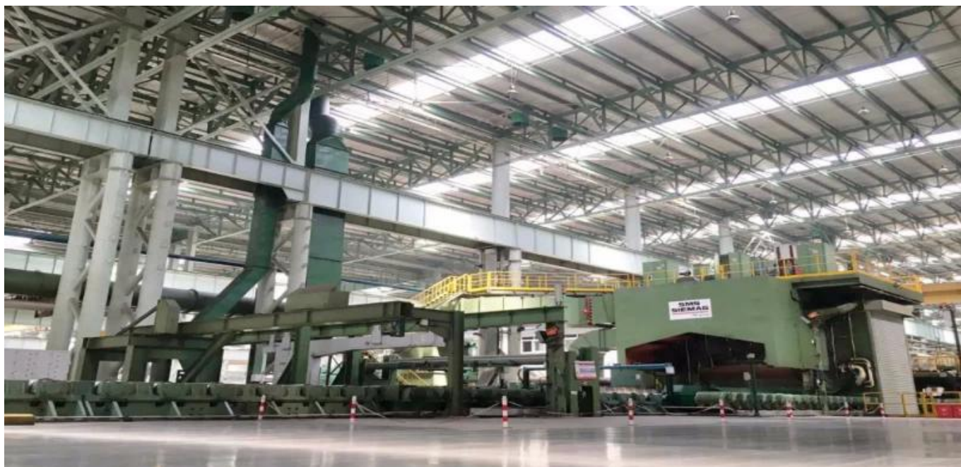
Оборудование для переработки
